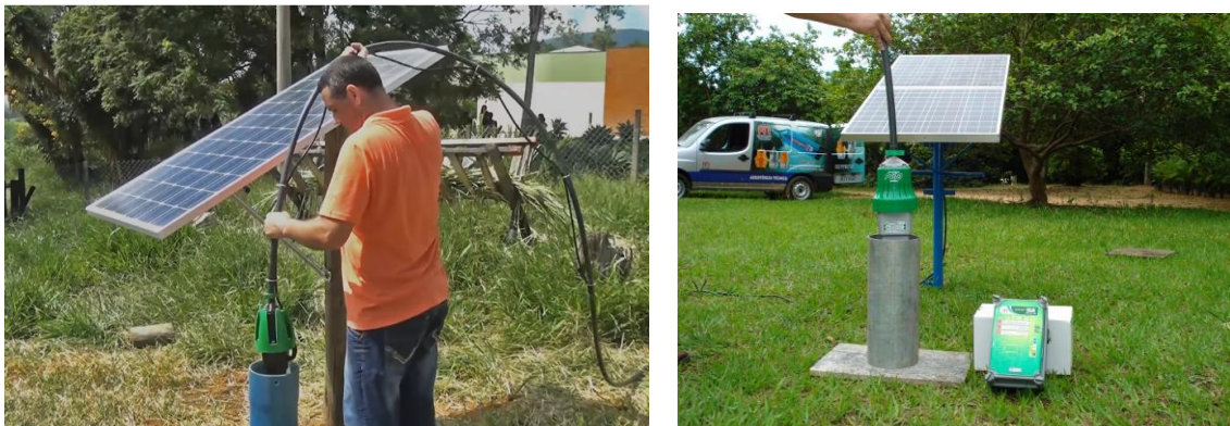
Figura 2.7: Exemplo de uma instalação com bomba de corrente contínua (pequena potência)
