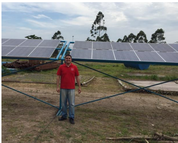
Figura 4.13: Instalação solar na comunidade
